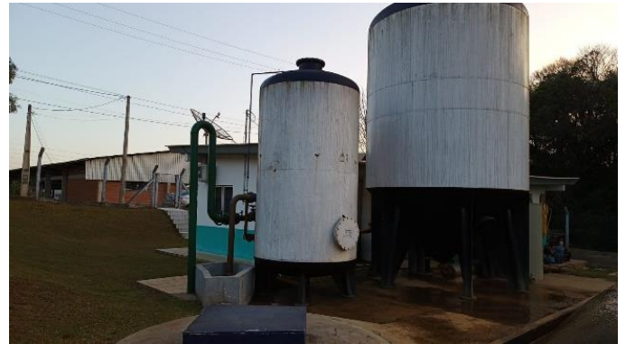
Figura 6: Estação de Tratamento de Água
