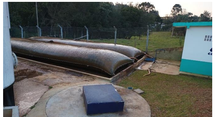
Figura 8: Tratamento de efluentes da ETA
