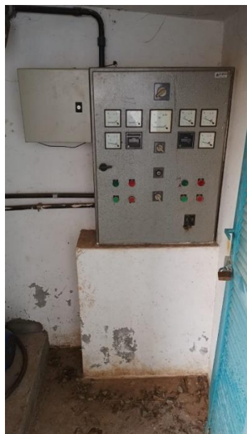
Figura 15: ERAT2 (painel de comando)
