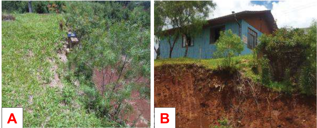
Figura 128: A: Muro inclinado indicando movimentação no terreno. B: Casa construída muito próxima ao corte no talude.
