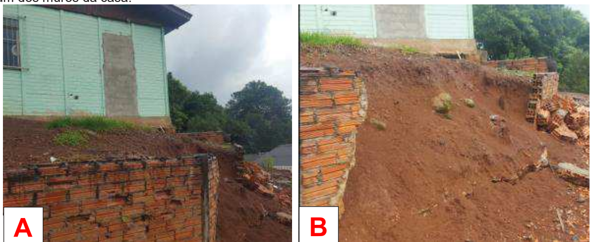
Figura 131: Residência localizada em um terreno colapsível onde a movimentação do solo derrubou um dos muros da casa.
