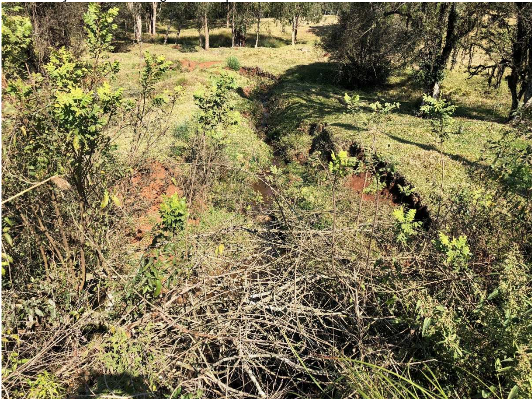
Figura 4: Tubulação do curso d'água "A" no ponto 5.
