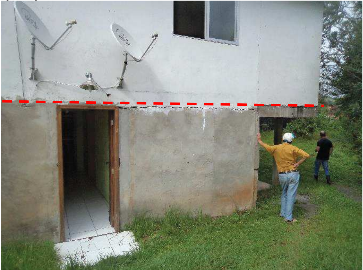
Figura 120: Residência atingida pela inundação. A Linha tracejada em vermelho indica o nível que a água chegou.
