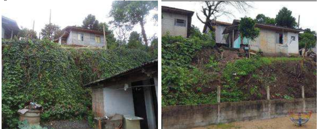
Figura 127: Moradias construídas muito próximas ao talude de corte.
