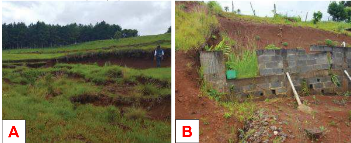
Figura 130: A: Feições erosivas nesta encosta. B: Muro de contenção que não foi dimensionado corretamente, construído pelos próprios moradores.
