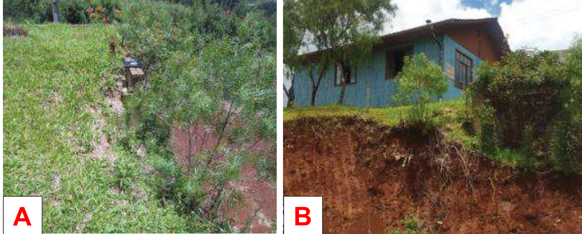
Figura 128: A: Muro inclinado indicando movimentação no terreno. B: Casa construída muito próxima ao corte no talude.
