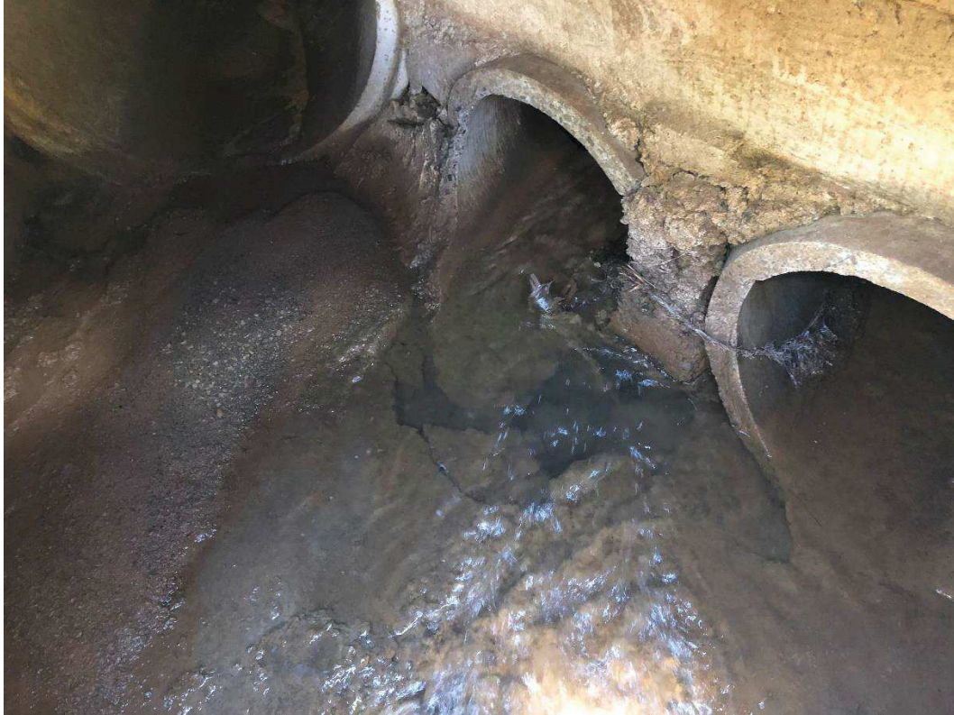
Figura 35: Caixa de passagem do curso d'água "F" no ponto 46.
